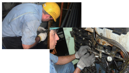
■「エアリーク撲滅活動」の一環として、コンプレッサの配管修理を徹底
